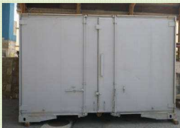
資材用コンテナの隙間
